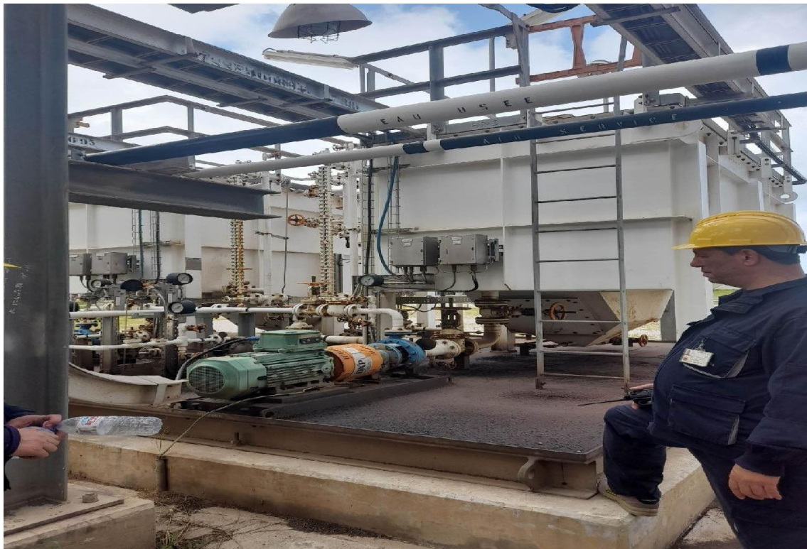
Figure -IV-2-: Station de traitement des eaux huileuse.
