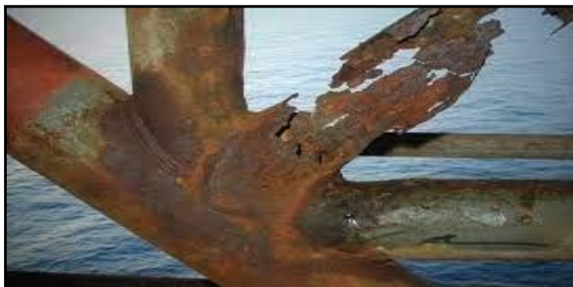
Figure I.11 : corrosion par fatigue
