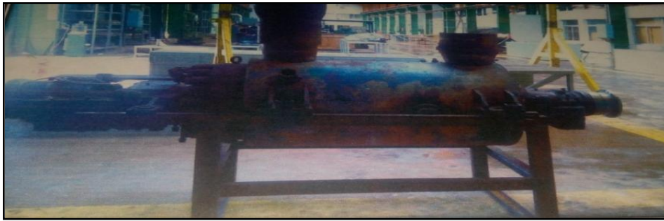
Fig.III.6. Vue générale de la pompe alimentaire HPT 28-20 à 8 étages
