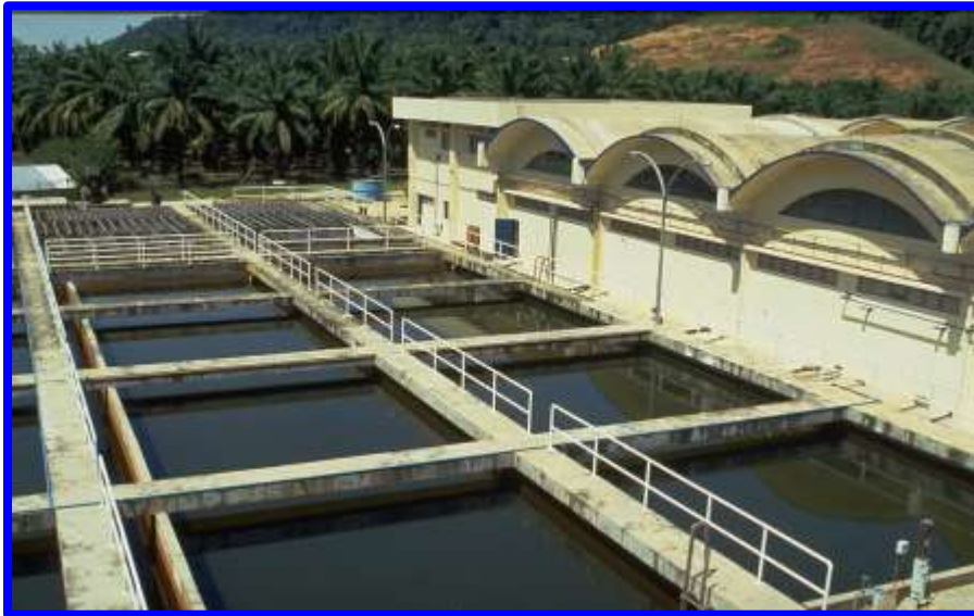
Figure I.6. Filtre à sable ouvert avec une régulation du niveau d'eau.
