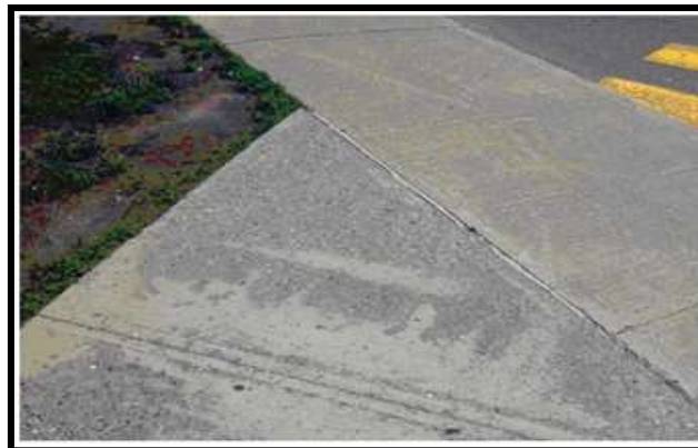
Figure IV.3 : Aspect visuel typique d'un élément de béton attaqué par l'écaillage en présence de sels fondants [15]
