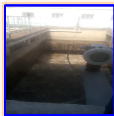
Figure II.14. Opération avant lavage des filtres
