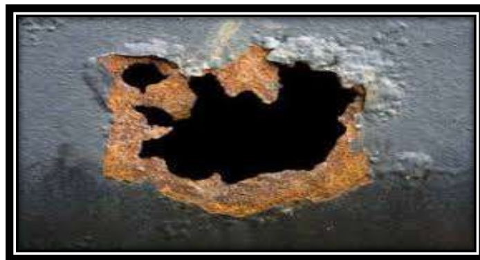
Figure I.8 : corrosion par piquûre [12].
