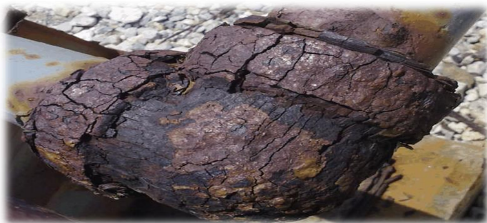
Figure I.8 : La corrosion- érosion.
