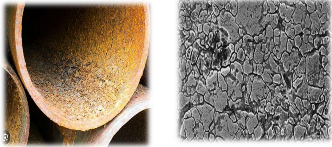
Figure I.7 : La corrosion inter granulaire.
