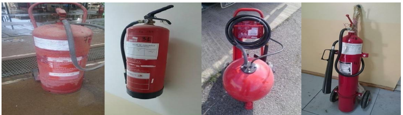
Figure III.13 : les moyens mobiles d'intervention
