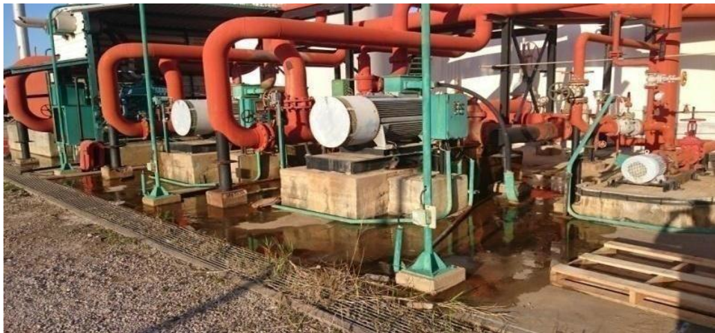
Figure III.6 Pompe du réseau d'eau anti-incendie
