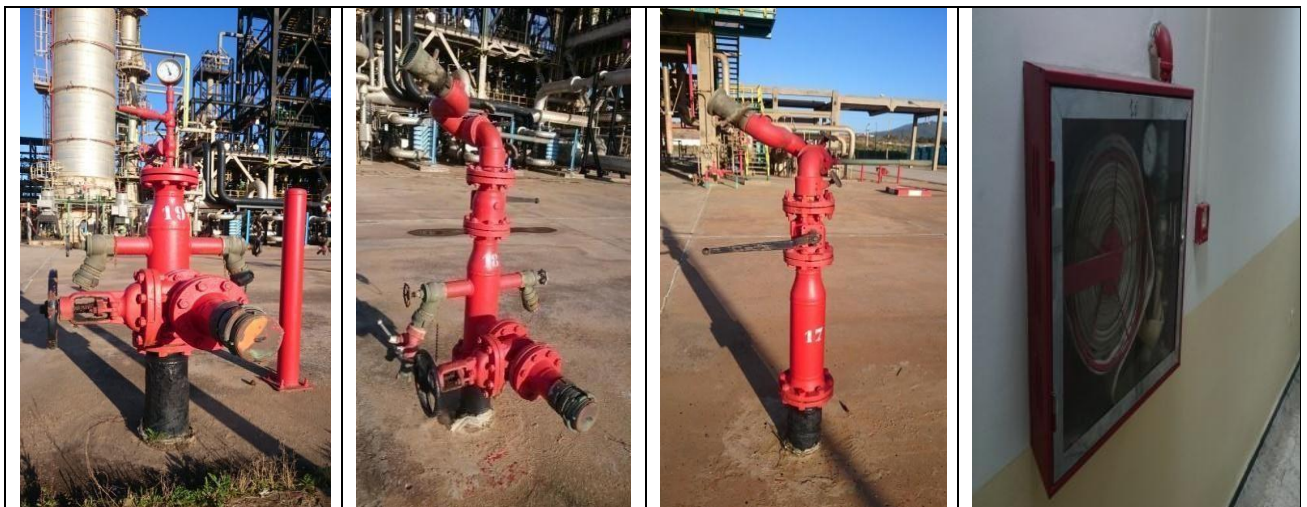
Figure III.8: les Postes de distributions et d'injection
