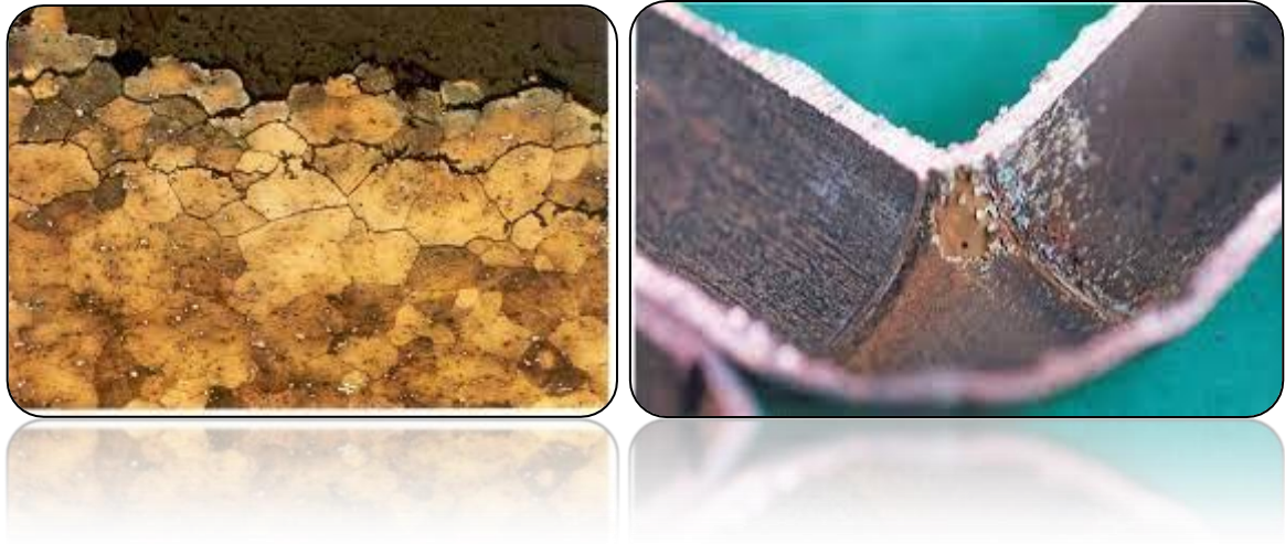
Figure. I.7 : La corrosion sous contrainte.
