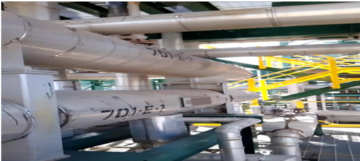
Figure III.10: Les réchauffeurs électriques de la section de régénération (700)
