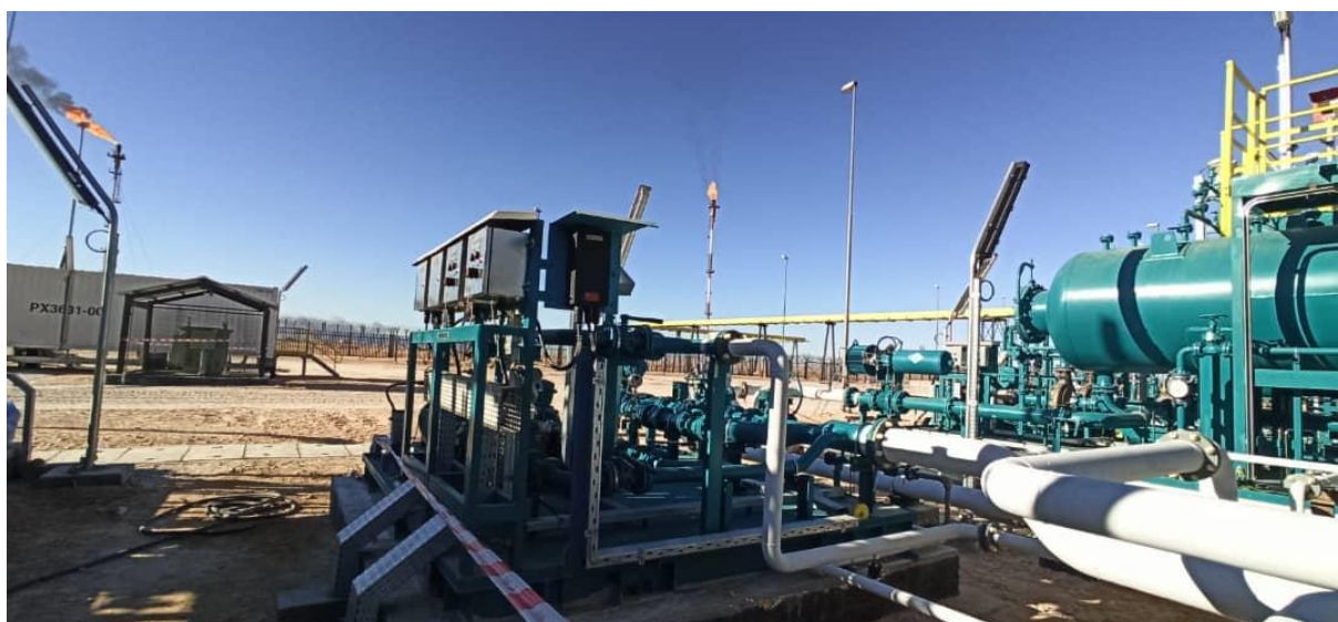
Figure .III.5 : Pompes de recyclage de l'unité IGF.
