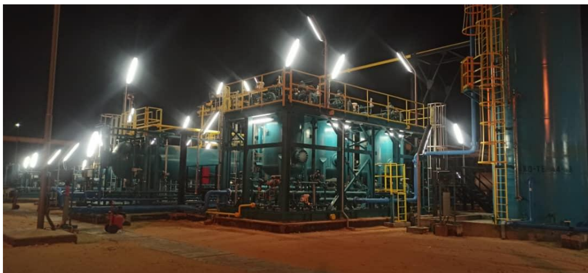
Figure.III.1 : Unité de traitement des eaux huileuses UTBS Hassi Messaoud
