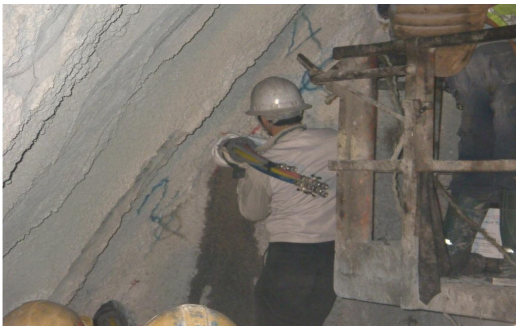
Figure 3.9: Mise en place des boulons en fibre de verre (Tunnel T4 –Algérie-)
