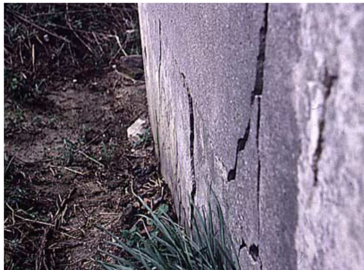
Figure I.9: Fissuration sévère d'un massif de fondation [27]
