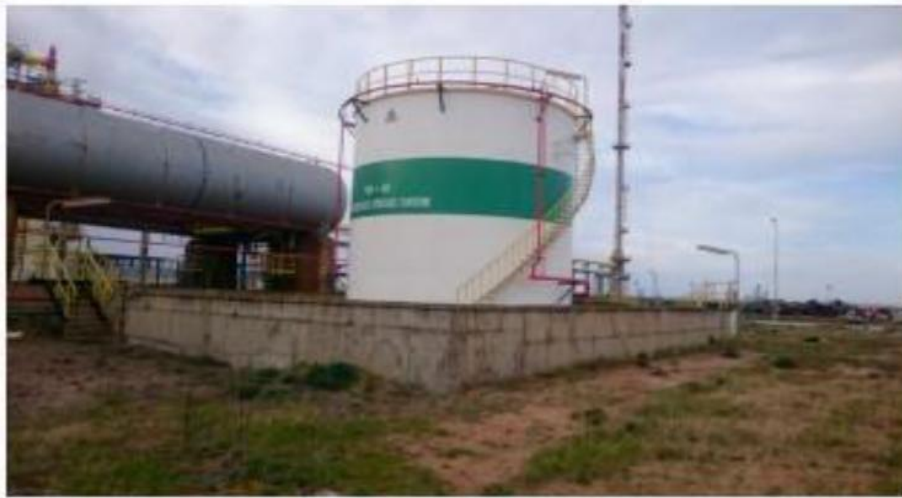
Figure III.4 : Le bac de stockage d'héxène au niveau de CP2K.
