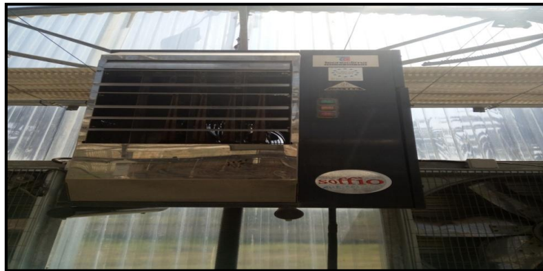
Photo 2. Chauffage d'air pulse (DABI et DANI, 2018).
