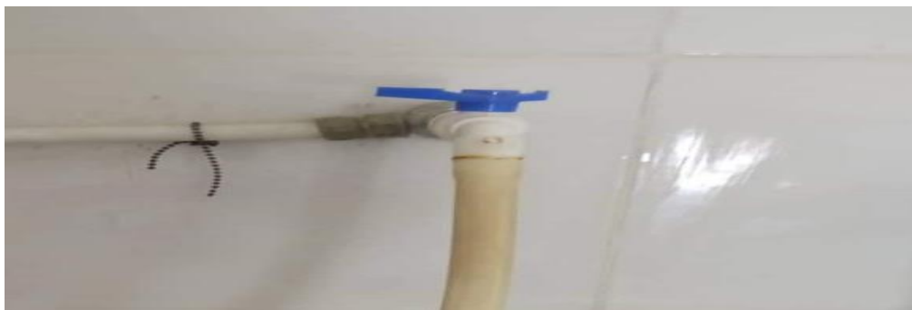
Figure 12: Robinet de prélèvement de l'eau traitée (station de traitement des eaux Zerdazas)
