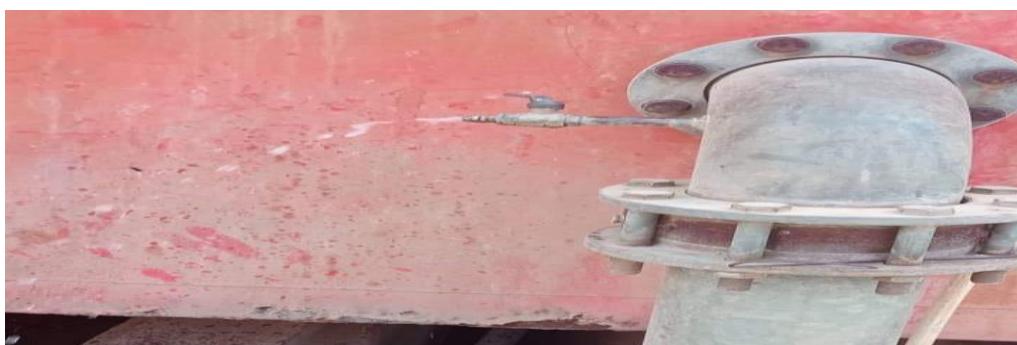
Figure 13: Robinet de prélèvement de l'eau brute (Station de traitement des eaux Zerdazas).
