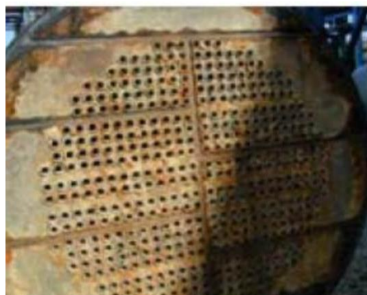
Figure II.11: Échangeur. Corrosion importante [12].
