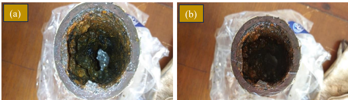
Figure III. 3 (a-b) : État des tubes des échangeurs avant et après le lavage chimique
