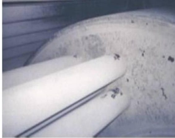
Figure II.9: Entartrage d'une chaudière à tube de fumée (P= 15 bars) [11].
