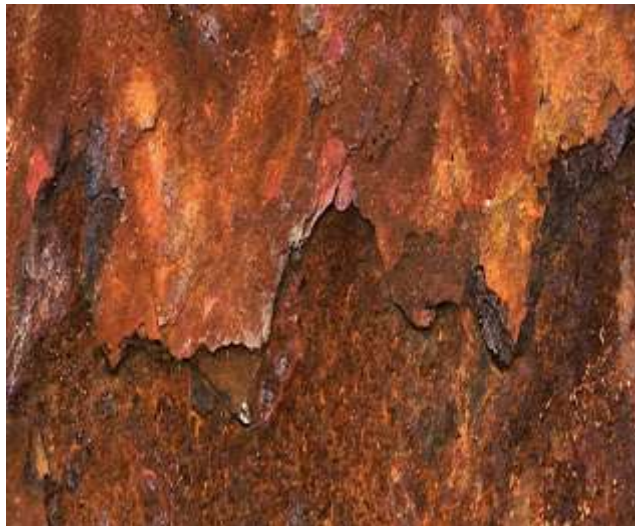
Figure II.2 : La corrosion chimique
