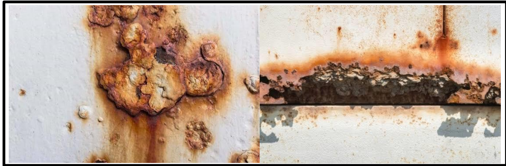
Figure I.4. La corrosion localisée.
