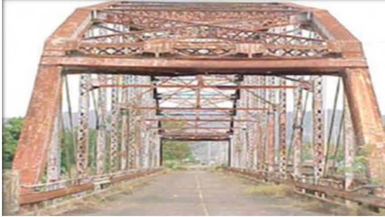
Figure I.3 : La corrosion uniforme d'un pont en acier
