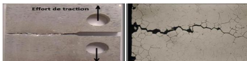
Figure I.9 : La corrosion sous contrainte
