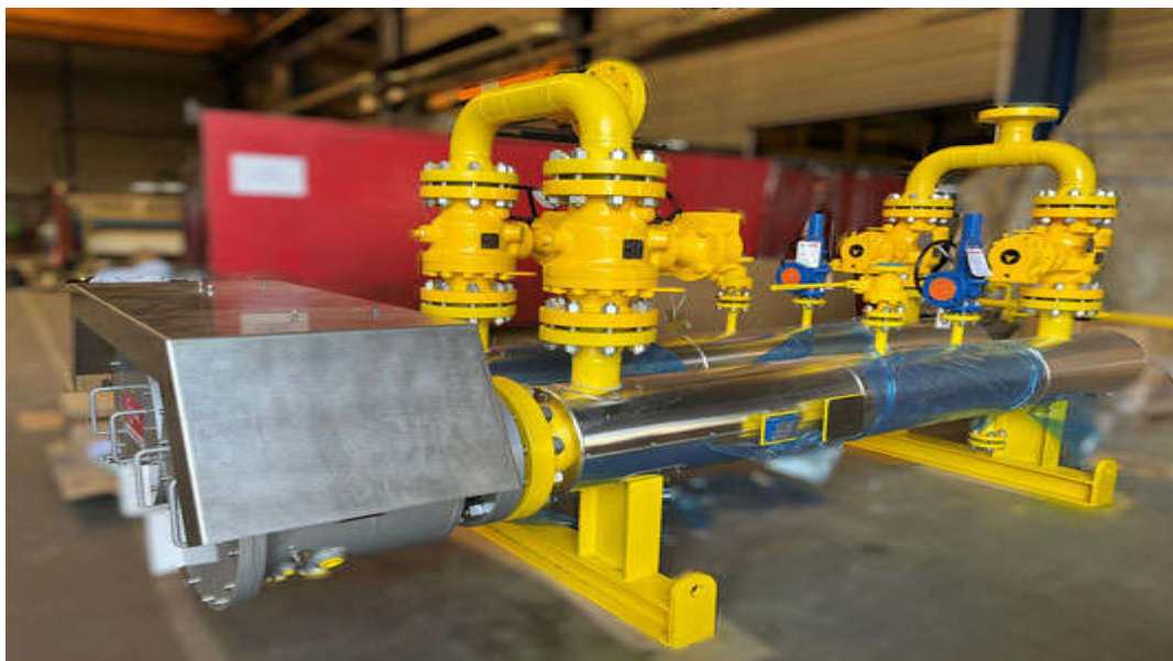
Figure IV. 12. Un Réchauffeur sur bande d'essai. [17].
