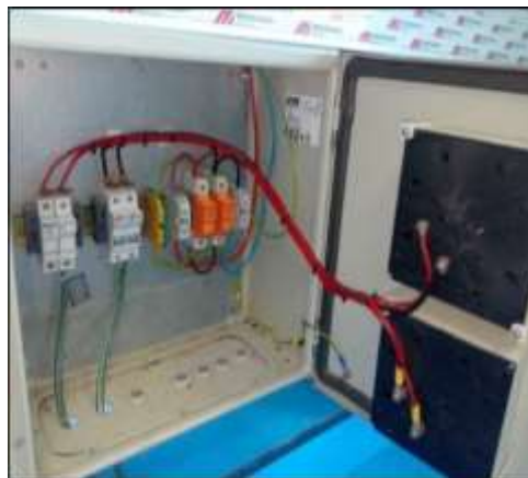
Figure A.5 : Composants de l'armoire électrique côté DC
