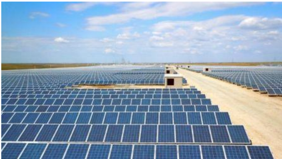
Figure I.5 : Installation photovoltaïque connectée au réseau dans le sud de l'Algérie
