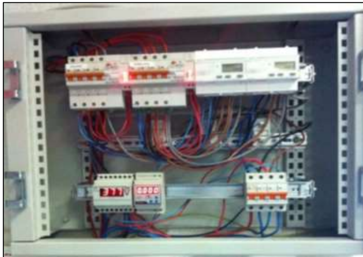
Figure A.8: Armoire de connexion au réseau
