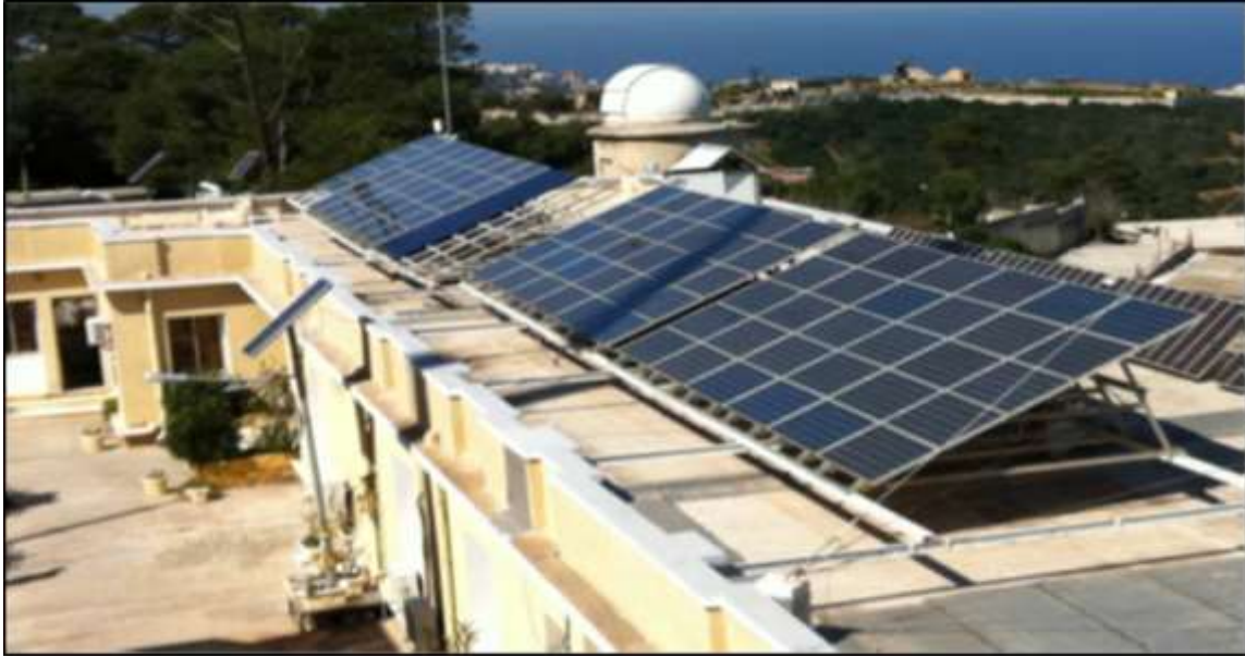
Figure A.3 : Générateur photovoltaïque du système
