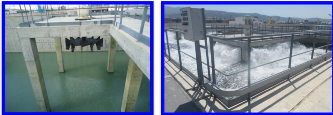
Figure IV.12. Bassin d'aération avec les turbines en marche et en arrêt
