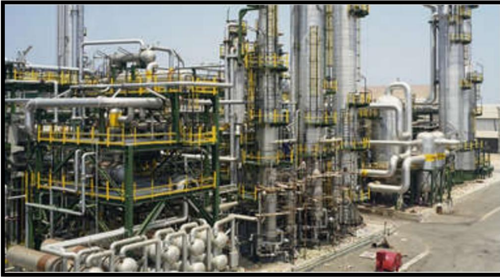
Figure II.9 : Vue d'une installation de traitement du gaz naturel [36].
