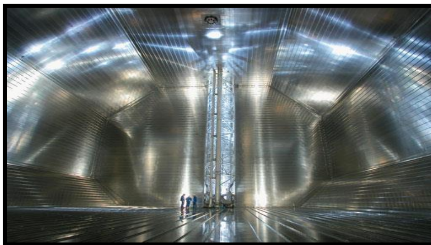
Figure II.13 : Intérieur d'une citerne de gazier [46].
