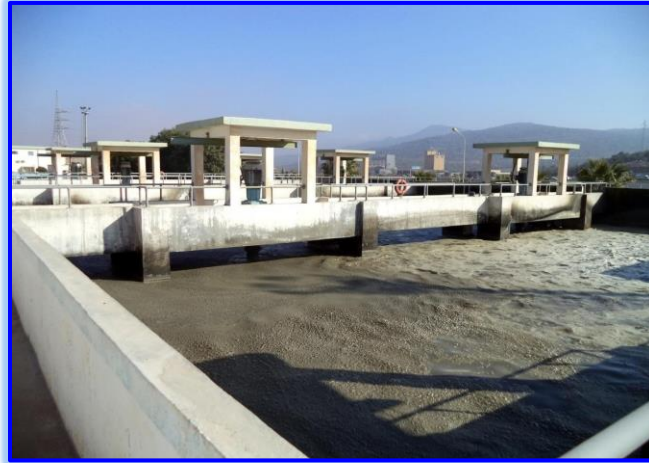
Figure II.10. Photo du bassin d'aération.
