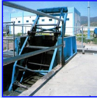
Figure II.06. Photo du dégrilleur mécanique
