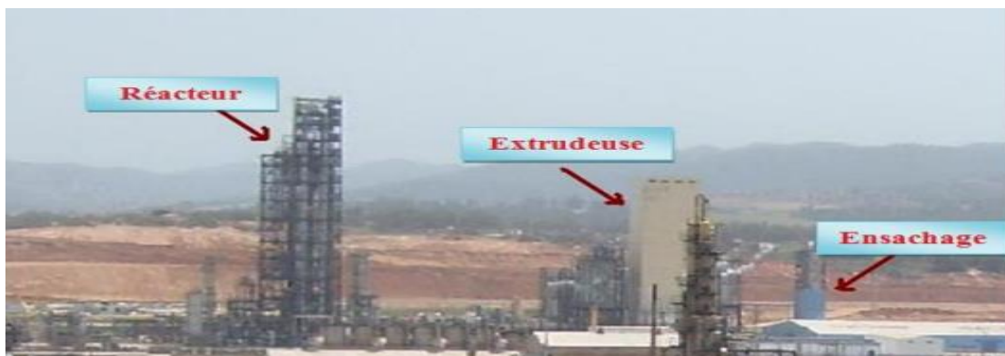
Figure B : Photo représentatif des principales installations de l'unité CP2K
