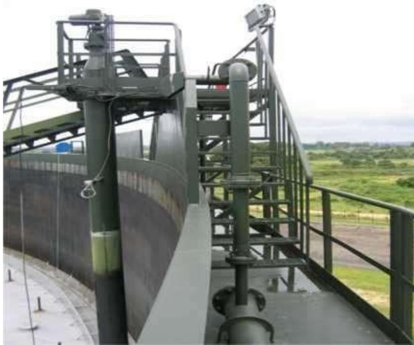
Figure III-9 Les accessoire d'accès au réservoir
