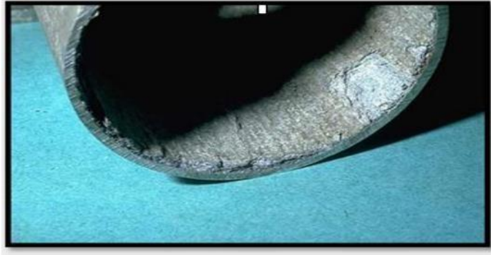
Figure I.5 : Corrosion feilletant d'une canalisation en alliage d'aluminium véhiculant de l'eau.
