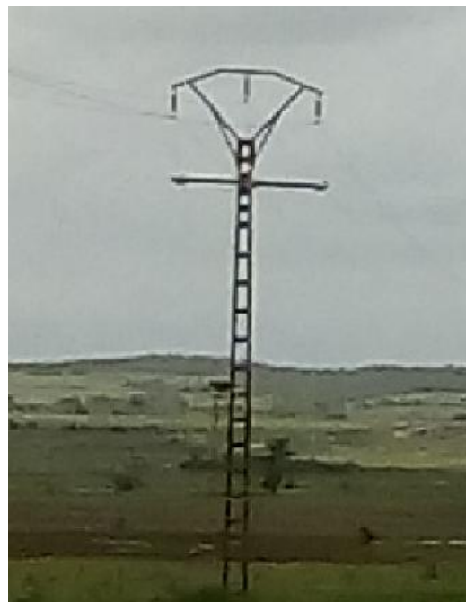
Figure V.2. Poteau métallique à conducteurs suspendus (S. Babouri, le 10/04/2018).
