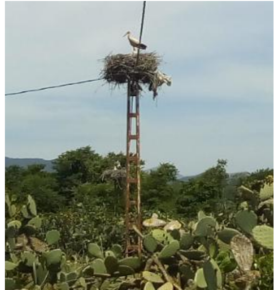
Photo A9. Un nid de la Cigogne blanche placé sur un poteau électrique métallique nain (Douar El Zouaraâ, Ben Azzouz, mai 2019).
