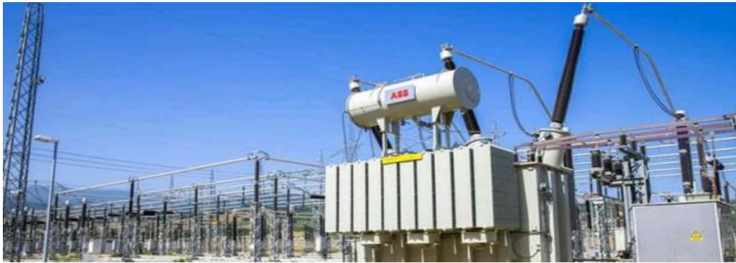
Figure 3.18. Sous-station électrique (MRSS)[37].
