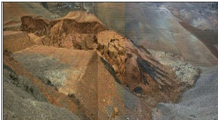
Figure 15: Glissement spectaculaire du remblai (pk190) et son sol support, en fin de construction.
