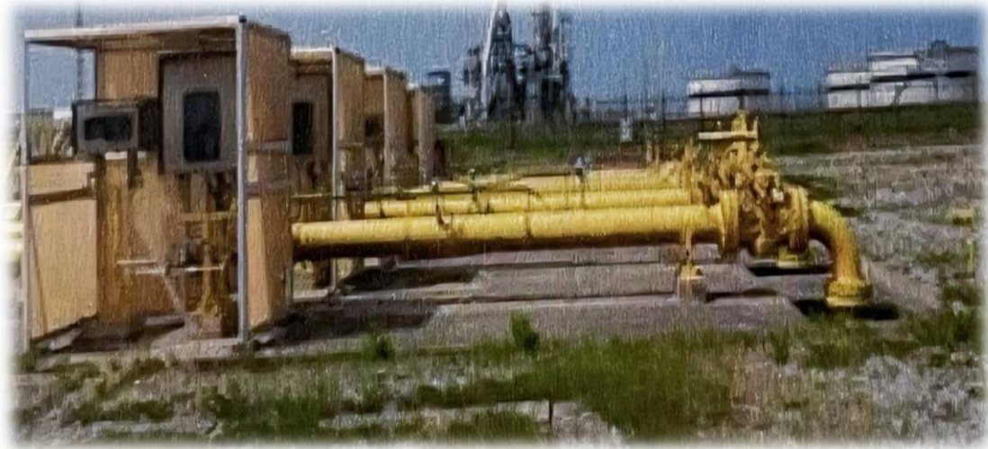
Figure IV. 13. Rampes de comptage GK3.
