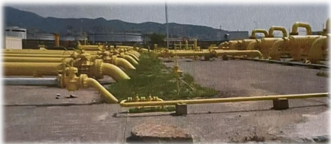
Figure IV. 12. Rampes de régulation GK3.
