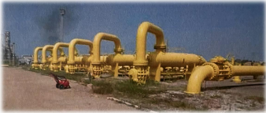
Figure IV. 11. Batterie de filtration principale GK3.
