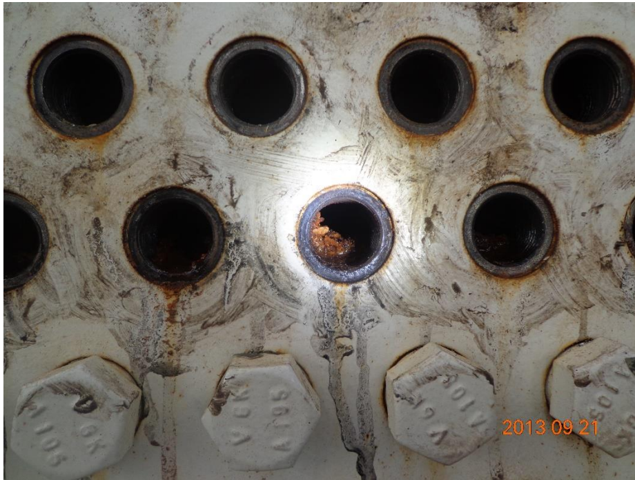
Figure III.2 : Importante corrosion sur les tubes des aéroréfrigérants [19].
