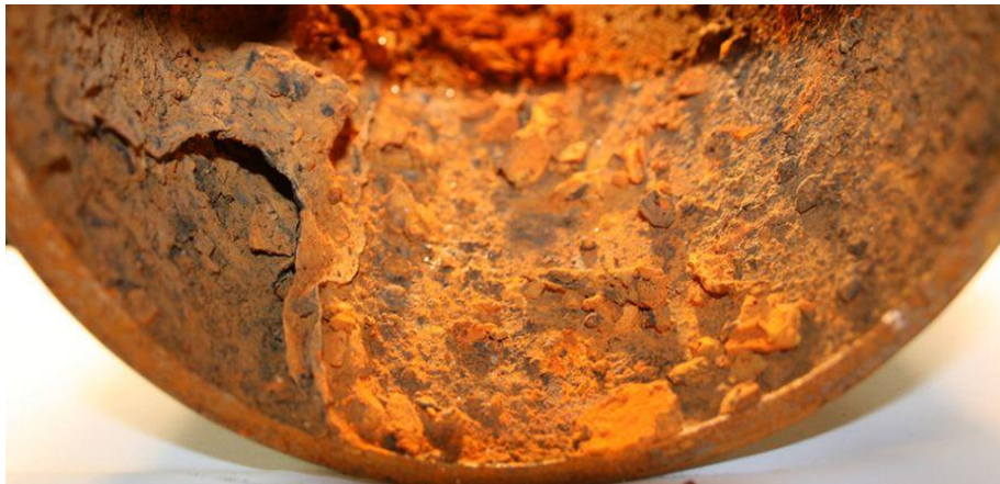
Figure. I.16. Corrosion généralisée d'un d'acier au carbone.
