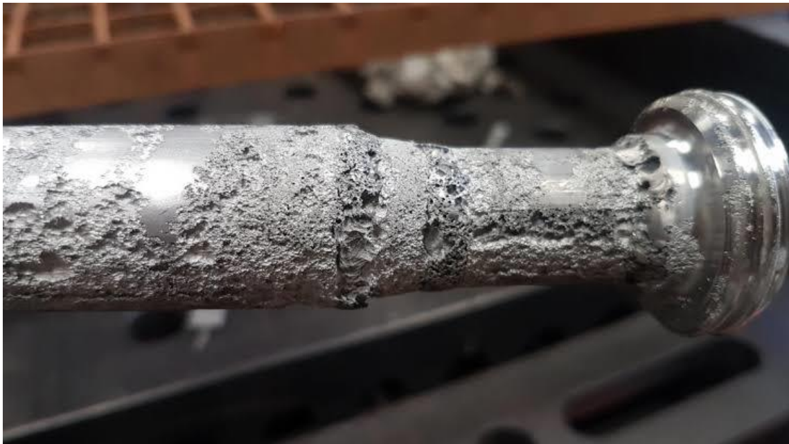
Figure. I.14. Corrosion cavernouse d'un l'acier inoxydable.
