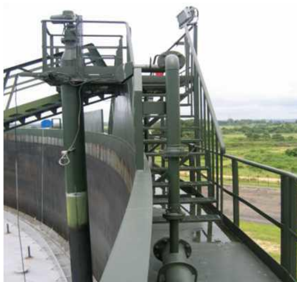
Figure III.5. : Les accessoires d'accès au réservoir.
