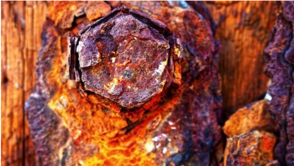
Figure I.17 : Corrosion par les eaux [29].
