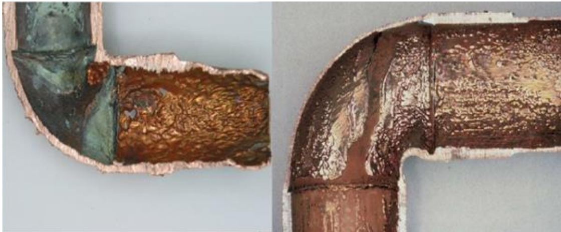
Figure 1,9 : Corrosion par abrasion dans les pipes en cuivre
