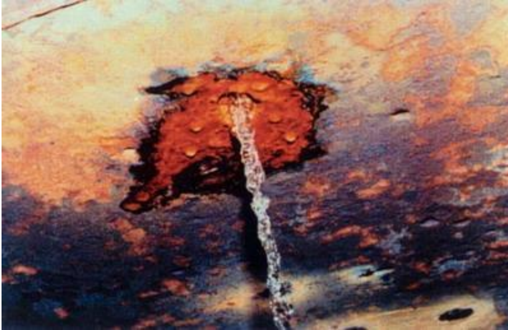
Figure I.4 : Corrosion microbiologique sous-cratéristique
