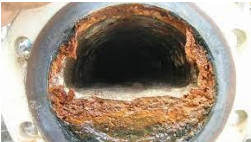
Figure I.1 : La Corrosion microbienne des conduites d'eau
