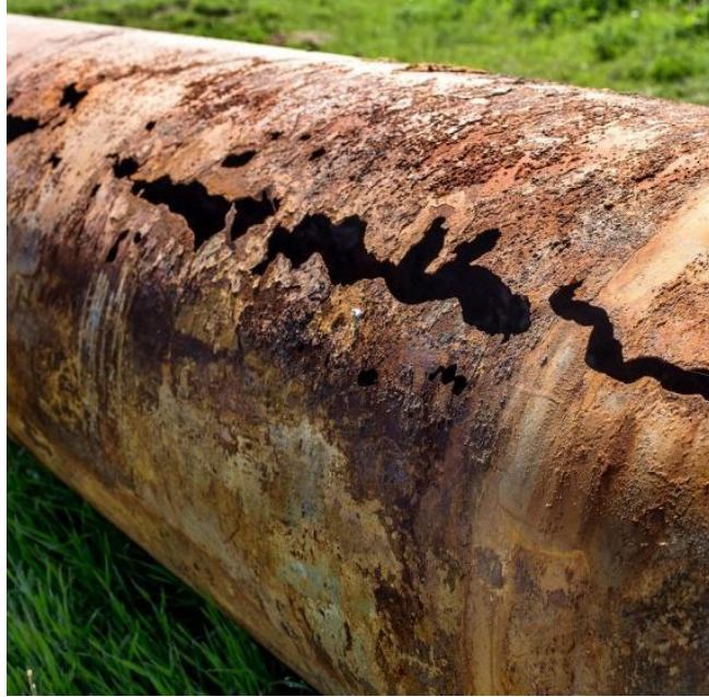
Figure I.3 : Corrosion microbiologique localisée
