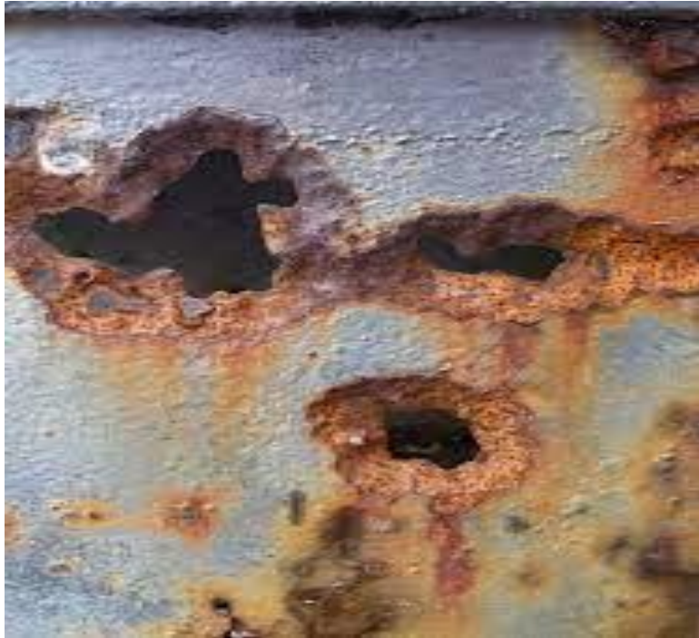
Figure I.6 : Corrosion microbiologique par piqûres
