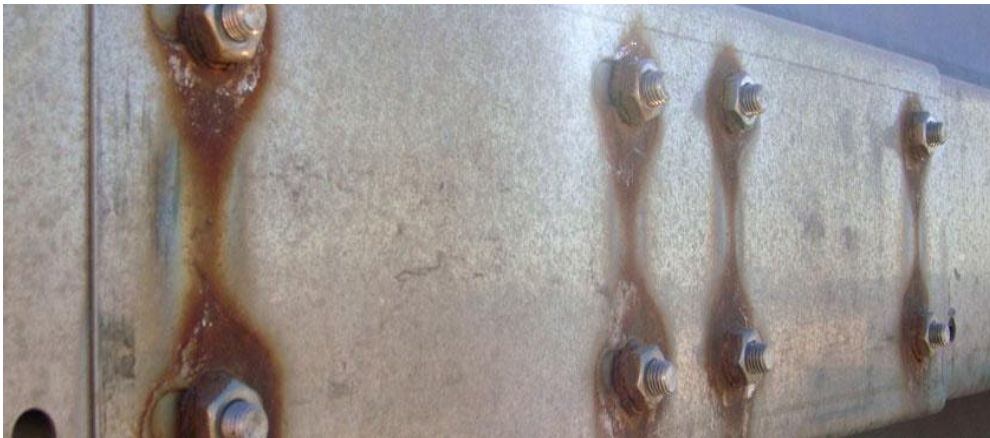
Figure I.5 : Corrosion microbiologique galvanique
