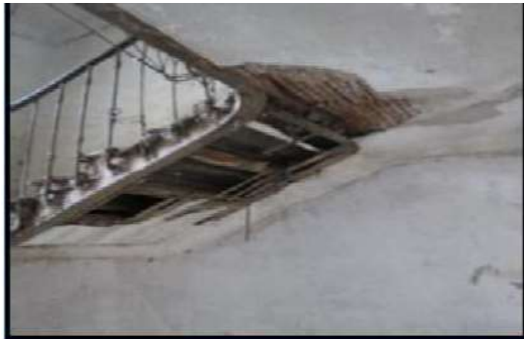
Figure II-13: Poutre corrodée du palier
