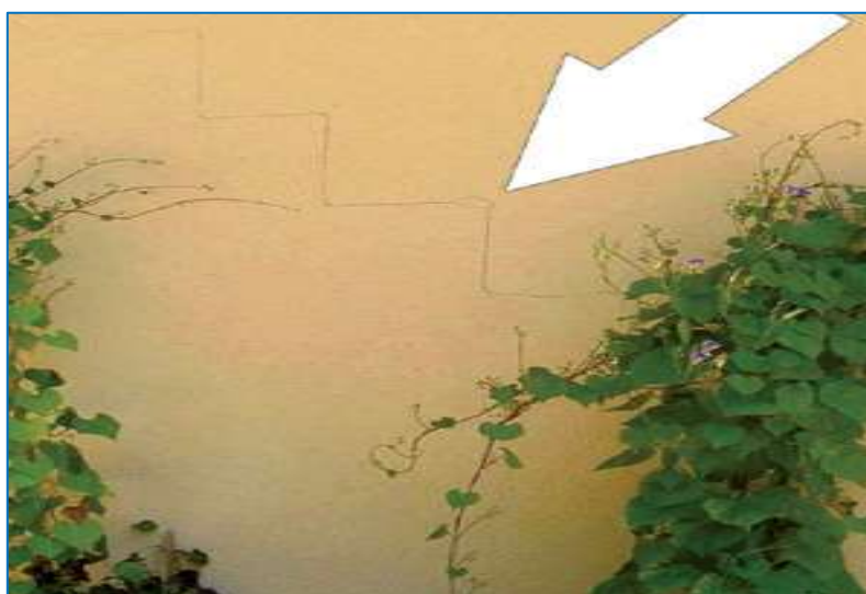
Figure I-7: Fissure ouverte suit les joints de la maçonnerie (Philipparie (2021))
