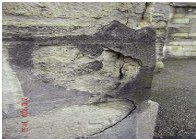
Figure I-9: Conséquences d'un rejointoiment bâclé et avec un mortier inadapté (crédit photo D. Poineau)
