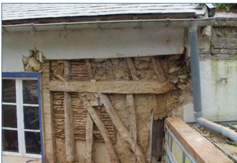
Figure I-5: Dégradation du bois
