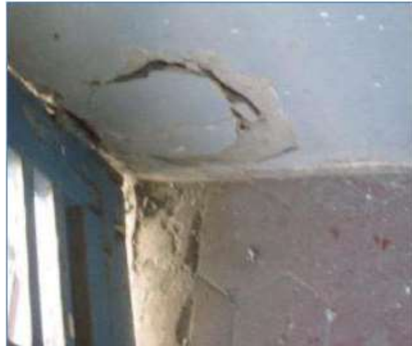
Figure II-5: Fissures et petites pertes de matériau aux jambages
