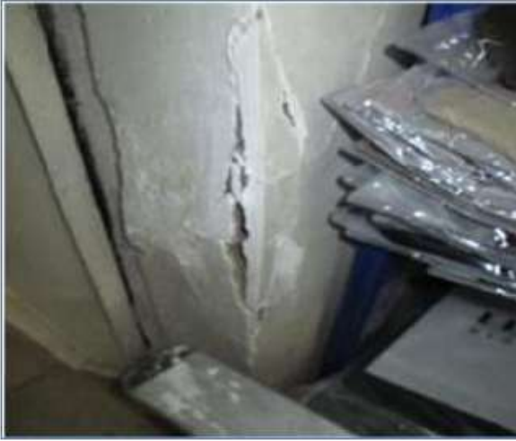
Figure II-4: Fissure verticale au mur
