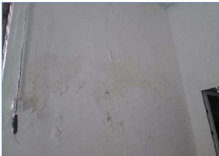
Figure II-9: Humidité de capillarité au mur de la façade latérale sud
