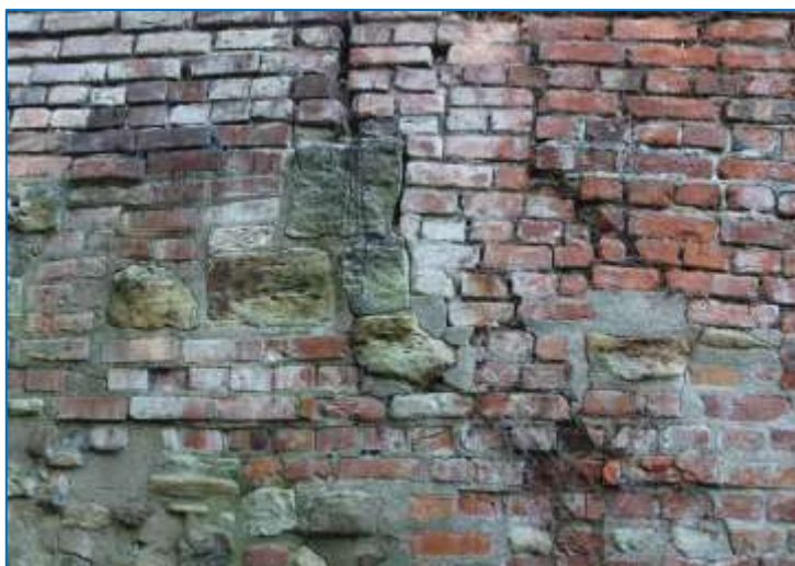
Figure I-6: Fissures sur la maçonnerie, la pierre et la brique (Source Pixabay / CC0 Creative Commons)
