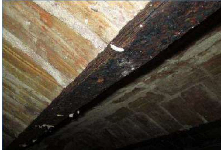
Figure II-12: Corrosion des poutrelles métalliques
