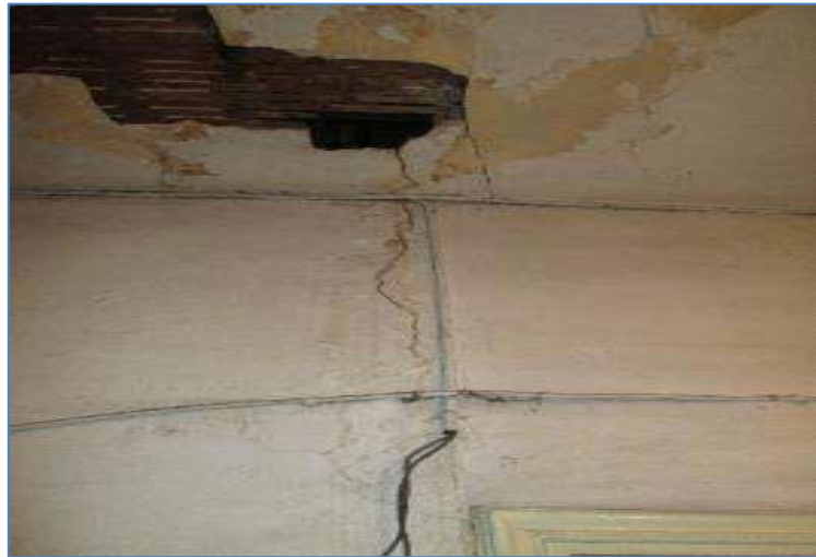
Figure II-3: Fissure verticale au mur du 3ème étage
