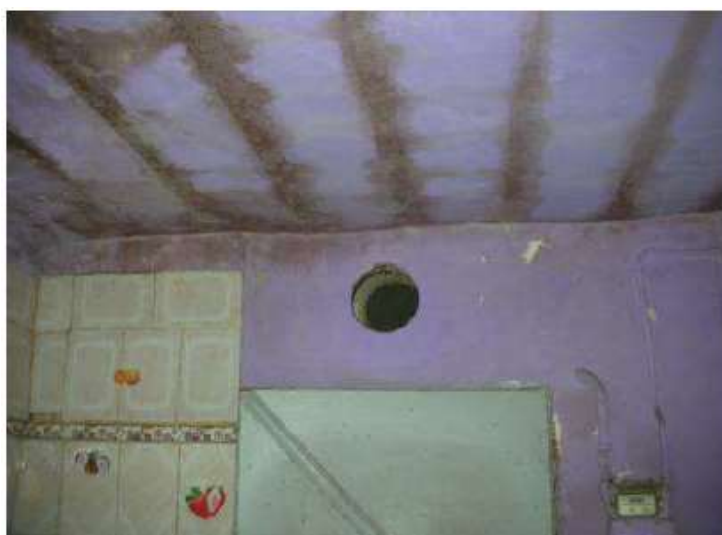
Figure II-10: Taches de condensation sous les poutrelles métalliques
