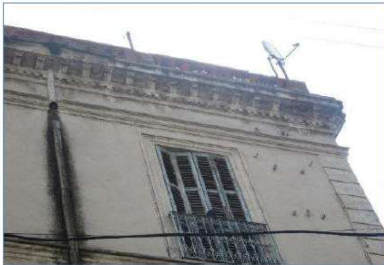
Figure II-11: Descente endommagée à la façade postérieure.
