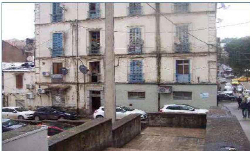
Figure II-14: Climatiseurs et antennes qui altèrent l'image du bâtiment
