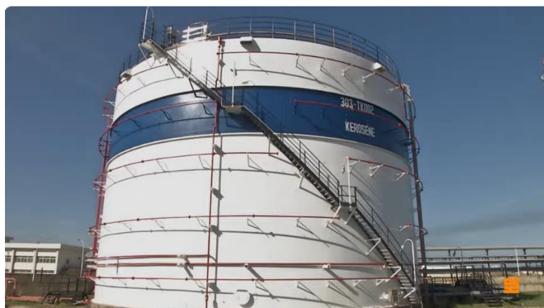
Figure III.5. Bac de stockage du kérosène.
