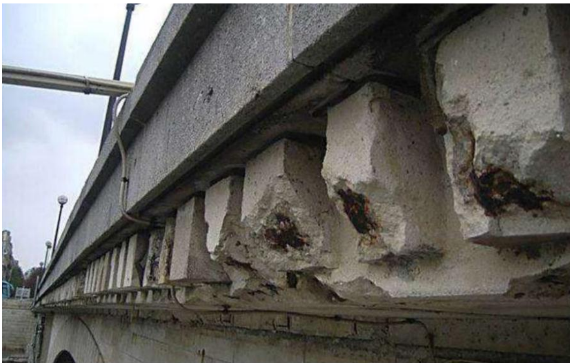
Fig.II.7: Au niveau des modillons au premier plan, des épaufrures laissent apparaître les aciers touchés par un phénomène de corrosion actif
