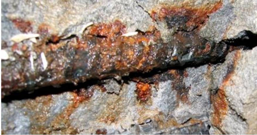
Fig 1: Photographie de la corrosion des aciers dans le béton
