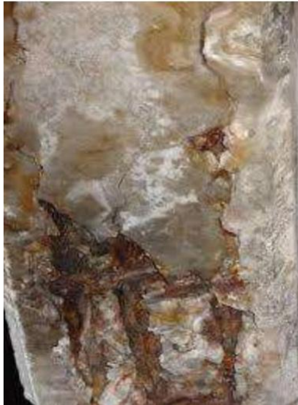
Fig.II.6 : Ouvrage d'un Parking d'aéroport concerné par la corrosion du béton.
