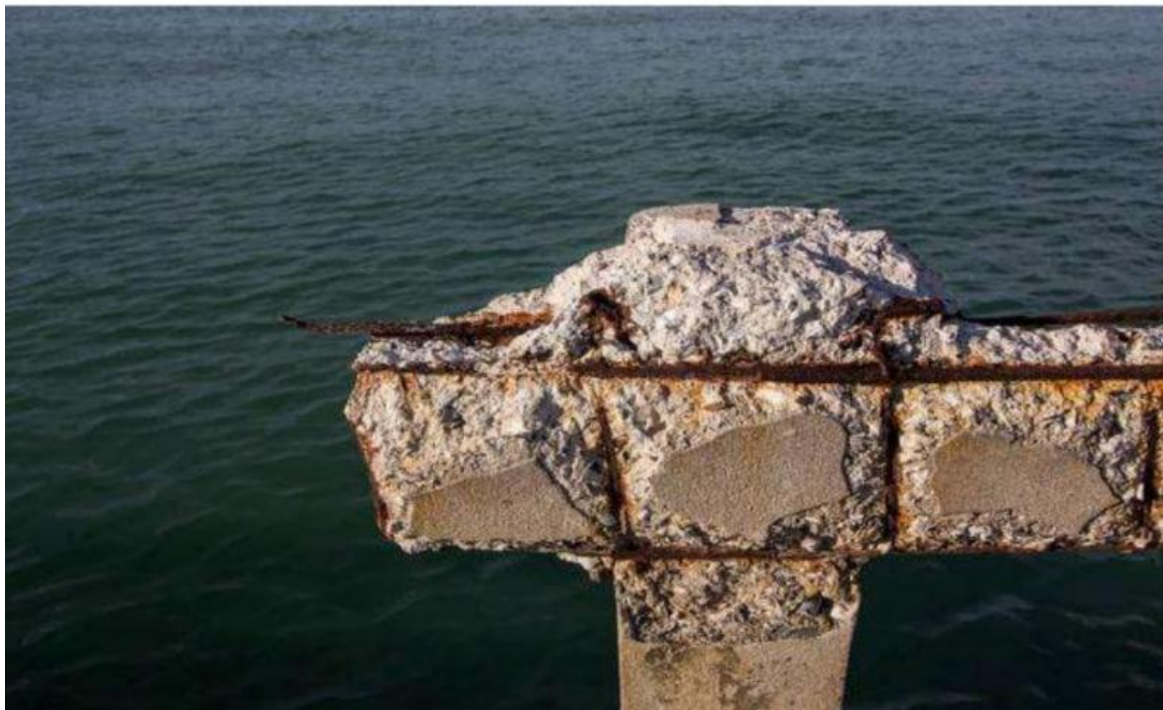
Fig.II.5: Ouvrage concerné par la corrosion du béton en milieu marin.
