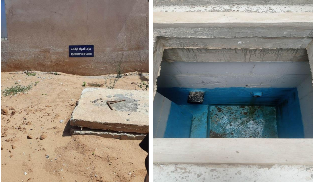
Figure III.12 : réservoir de saumure
