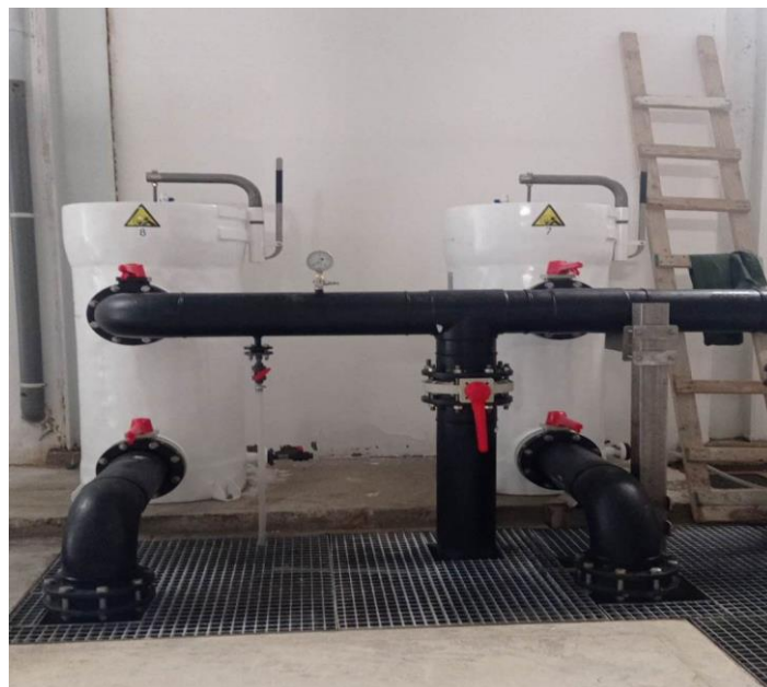
Figure III.8 : filtres à cartouches
