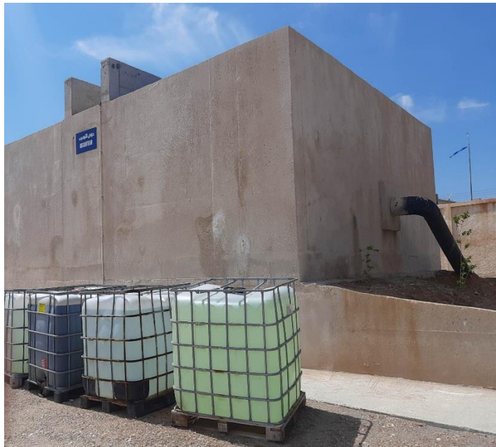
Figure III.6 : Décanteur de la station
