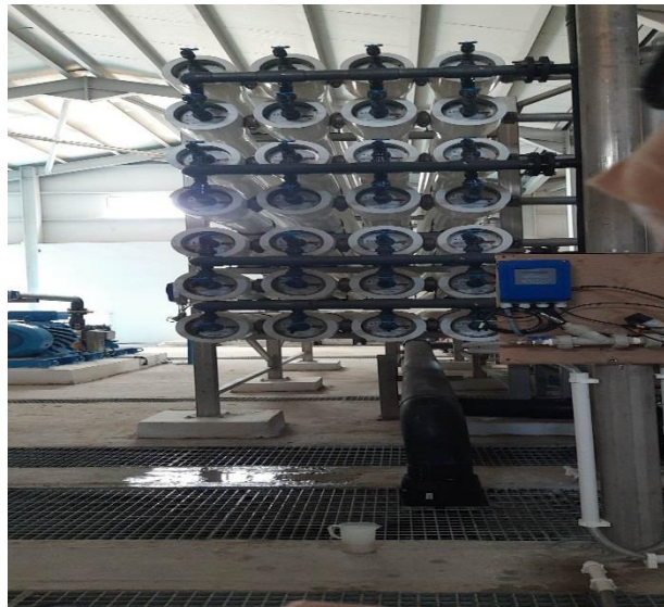
Figure III.9 : châssis des membranes d'osmose inverse
