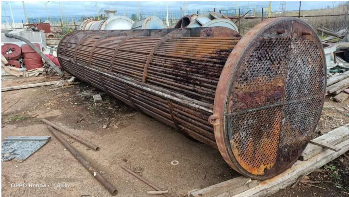
Figure 1 : Photographie de l'échangeur 100E115A/B
