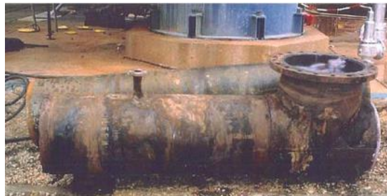
Figure. I.8: Corrosion sous contrainte par la soude d'un collecteur de vapeur en acier carbone.
