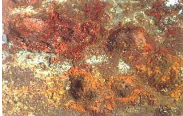
Figure. I.9: La corrosion sélective des tubes d'échangeurs.
