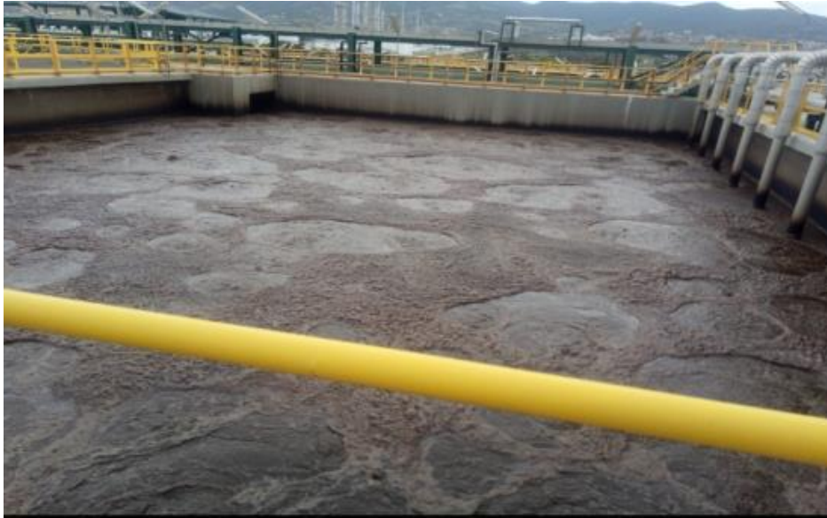
Figure II.11 : Bassin de traitement par boue active TN6.
