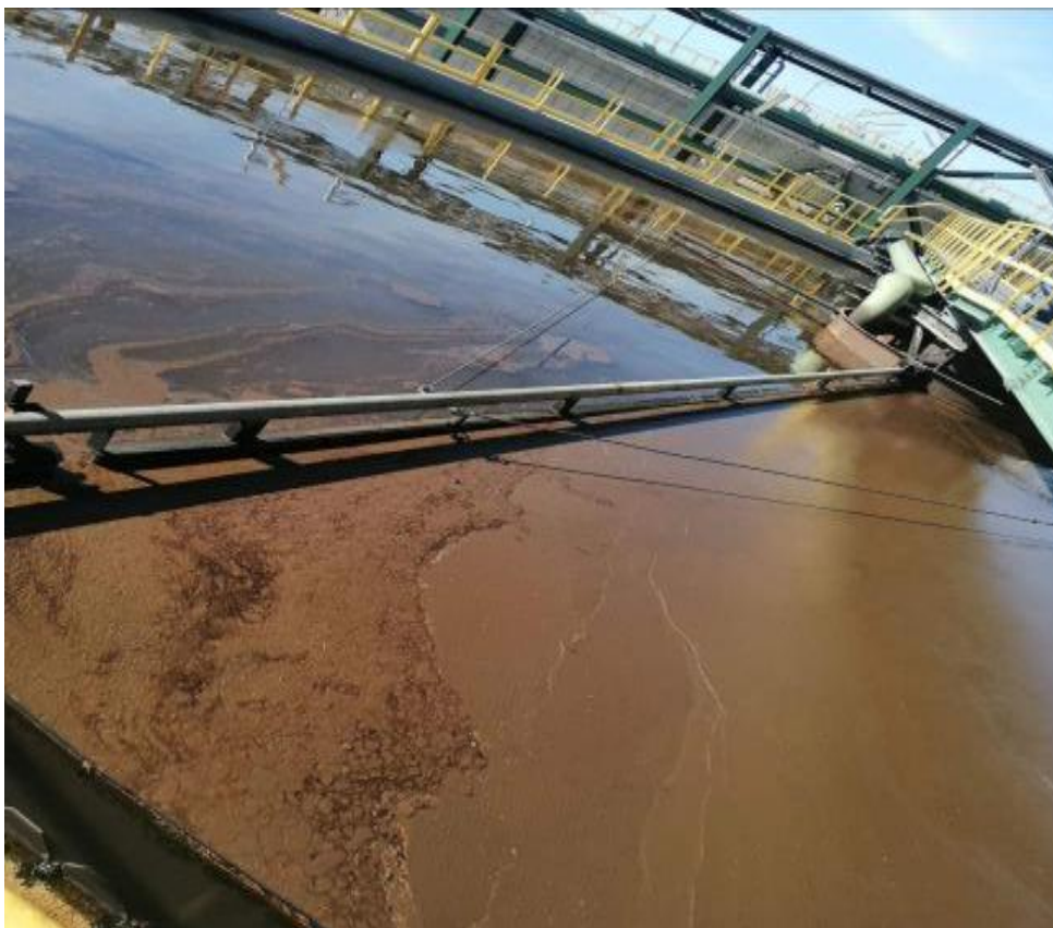
Figure II.14 : Clarificateur pour séparer la boue biologique CL-1A/.
