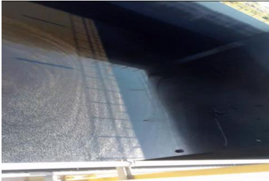
Figure II.6 : Bassin d'égalisation TN-1(A).
