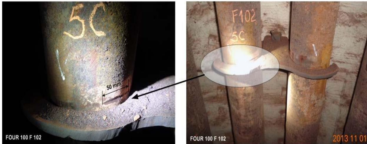
Usure par friction entre le support "Guide tube" et le "tube" au niveau de la zone radiante. - Profondeur: 01 mm - Longueur: 50 mm
