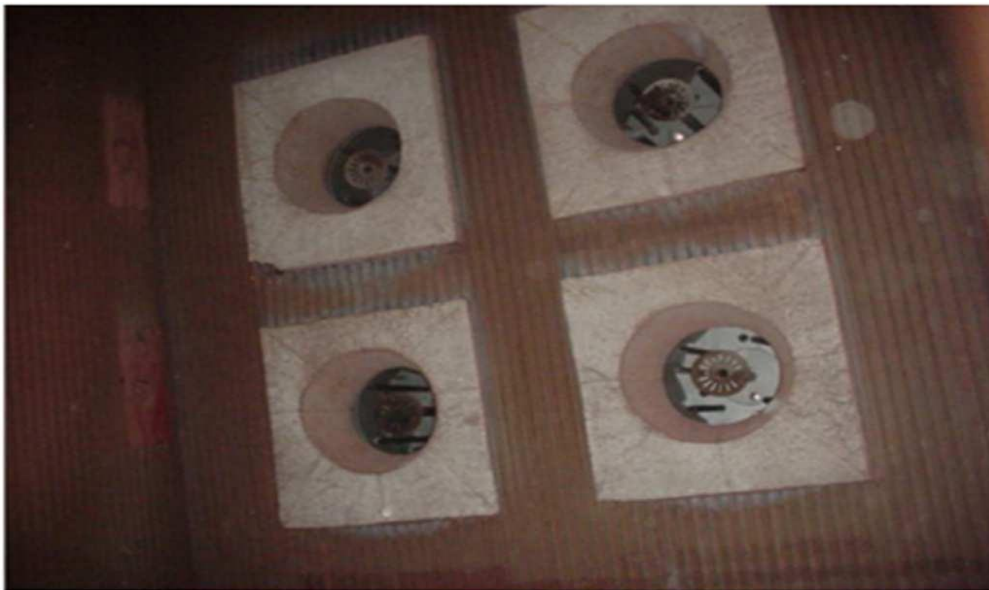
Figure 3.18: les brûleurs (Khadiche Manel & Amiar Bouchra, 2018).
