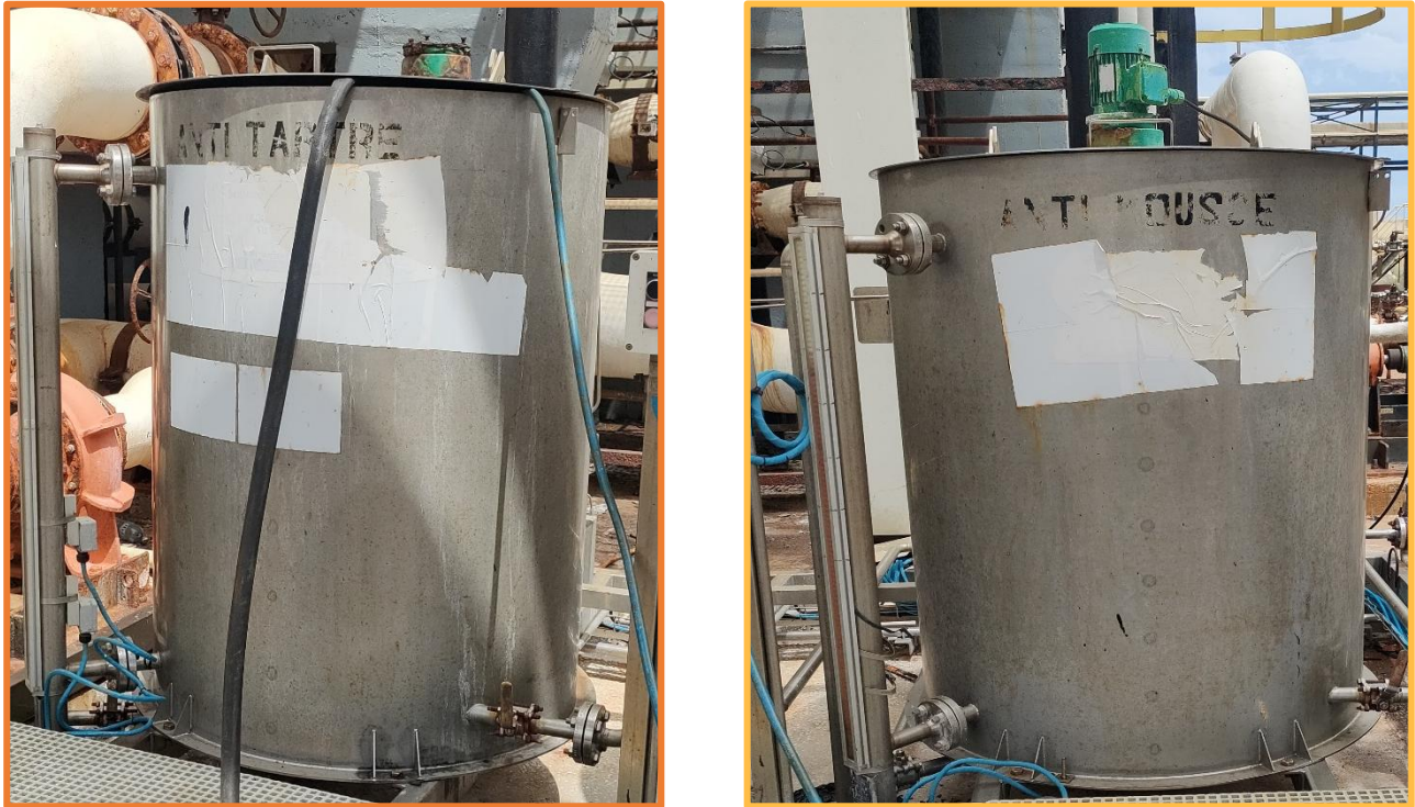
Figure III.14 : Bacs de dosage des produits chimiques.
