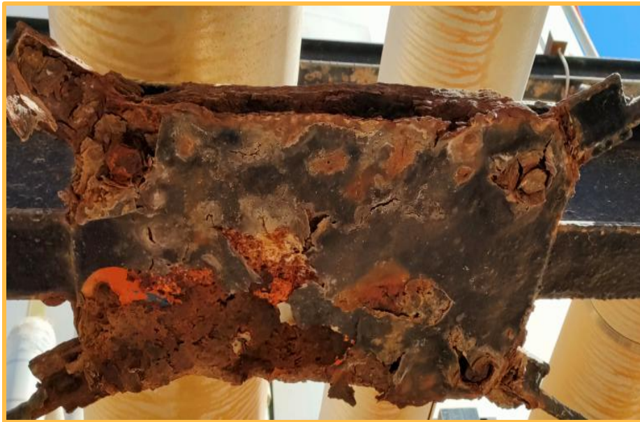
Figure II.8 : Corrosion généralisée d'un support métallique.
