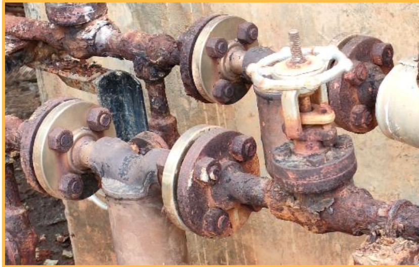
Figure II.9 : Corrosion localisée d'une bride (corrosion galvanique).
