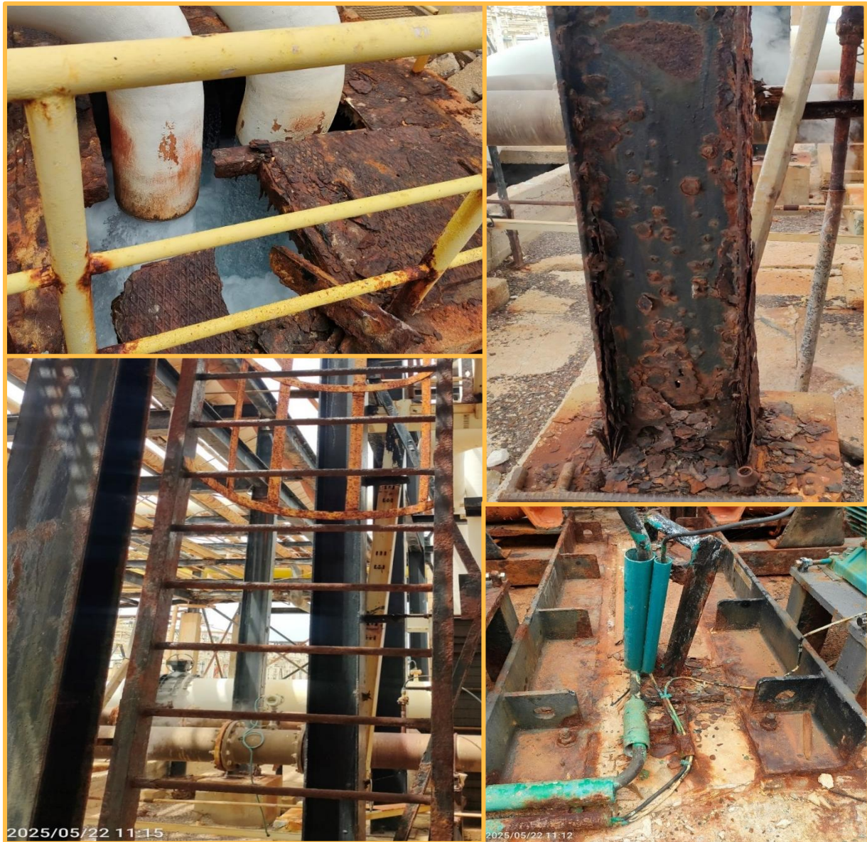
Figure IV.5 : Corrosion généralisée et localisée de la charpente métallique.
