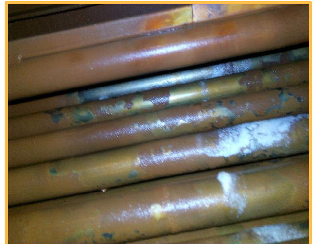
Figure IV.9 : Entartrage du faisceau de la 2 ème cellule.
