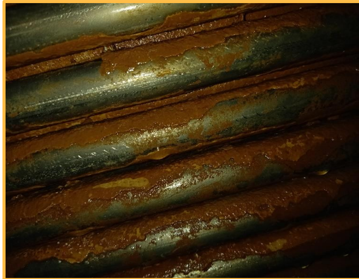
Figure IV.7 : Présence de tartre sur le faisceau des tubes.
