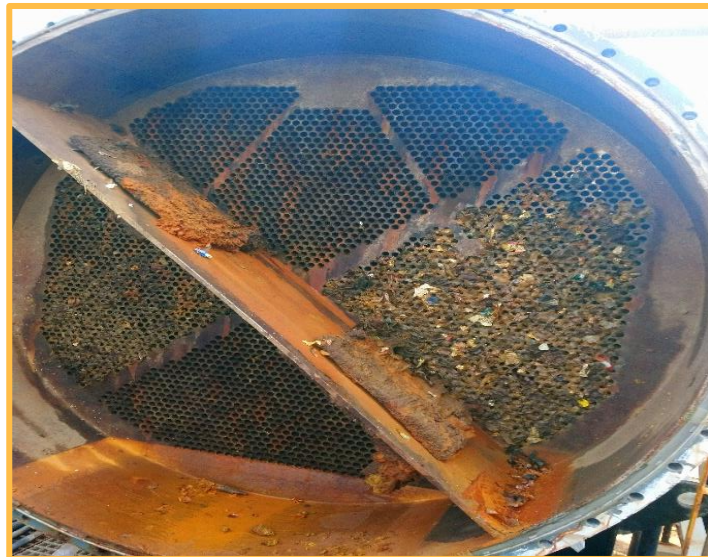
Figure IV.15 : Présence de la rouille et d'encrassement sur la paroi du faisceau tubulaire.
