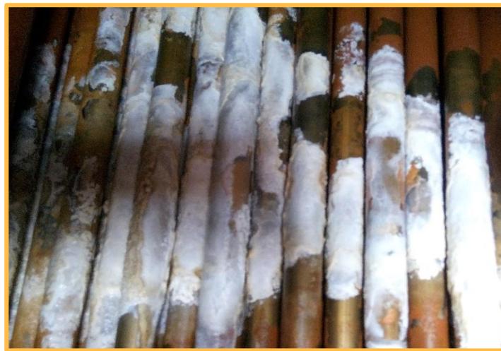
Figure IV.10 : Présence d'une couche de sel sur le faisceau tubulaire.
