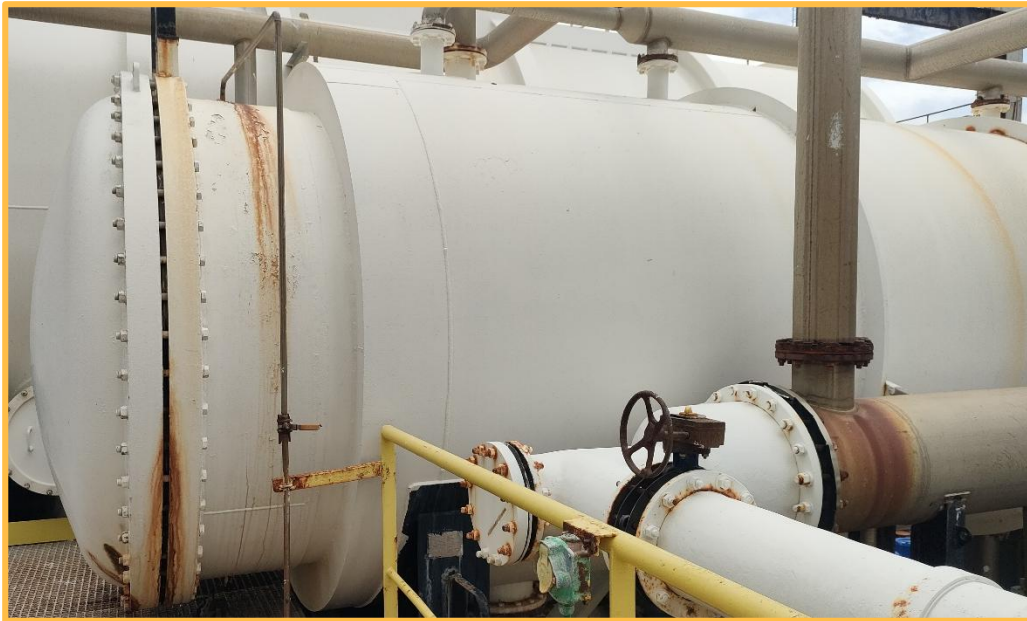
Figure III.11 : Condenseur de l'évaporateur.
