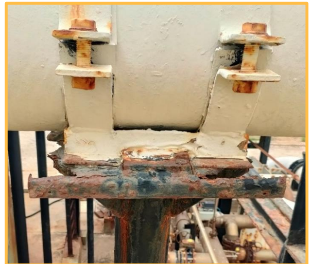
Figure IV.4 : Corrosion galvanique de la liaison support-tuyauterie.
