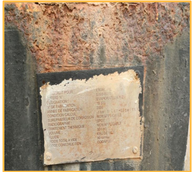
Figure IV.2 : Dégradation du support de la plaque d'identification.
