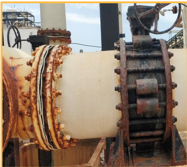
Figure IV.3 : Sévère corrosion des brides et vannes.
