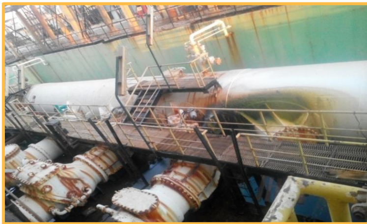
Figure IV.3 : Collecteur des refoulements des pompes.
