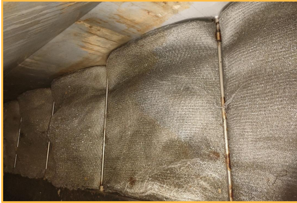
Figure III.9 : Les séparateurs (démisters).
