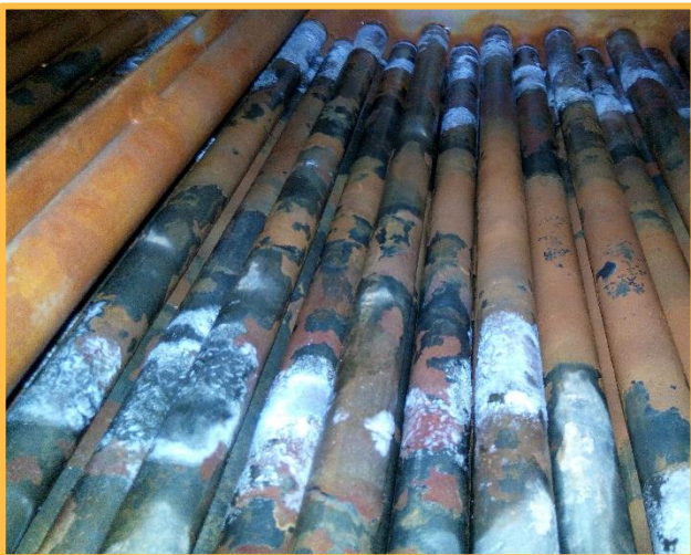
Figure IV.8 : Présence d'une couche de sel faisceau des tubes.
