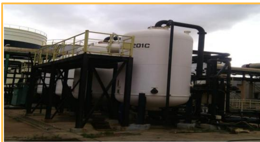
Figure IV.5 : Ioniseur de la section déminéralisation.
