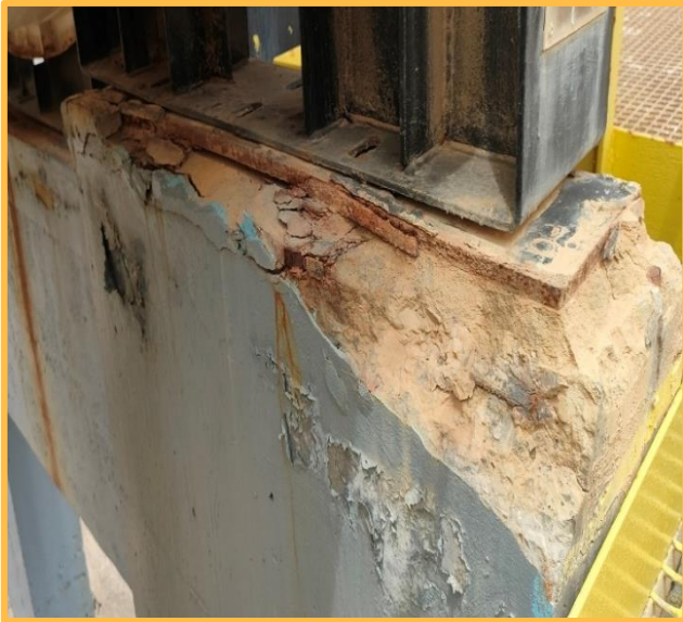
Figure IV.1 : Fissuration du massif.
