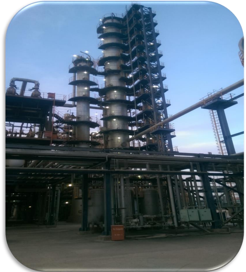
Figure V.5 : représente la colonne de distillation atmosphérique C-201 102
