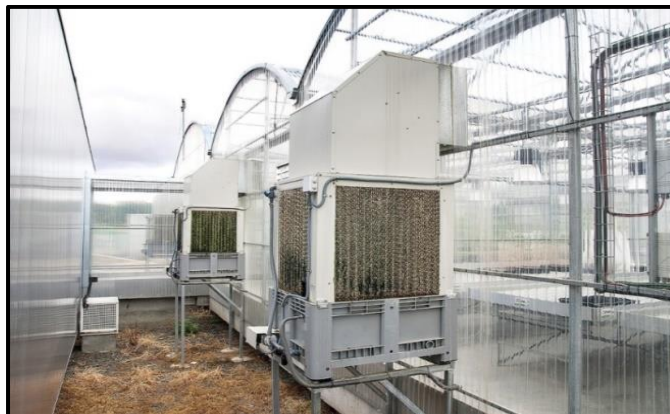
Figure22 : cooling d'une serre
